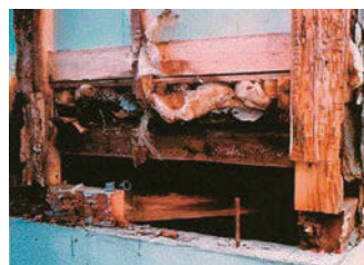
内部結露により躯体が腐朽
