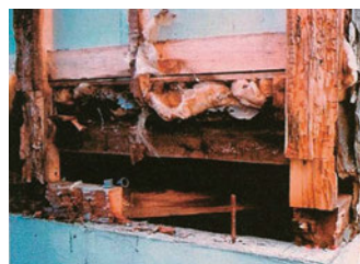
内部結露により躯体が腐朽
