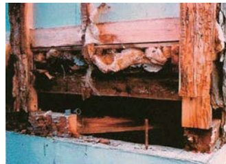
内部結露により躯体が腐朽
